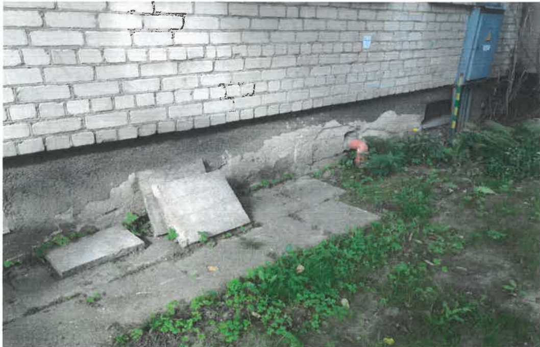
13pav. Ne visur įrengta nuogrinda, aprtrupėjęs cokolis.
