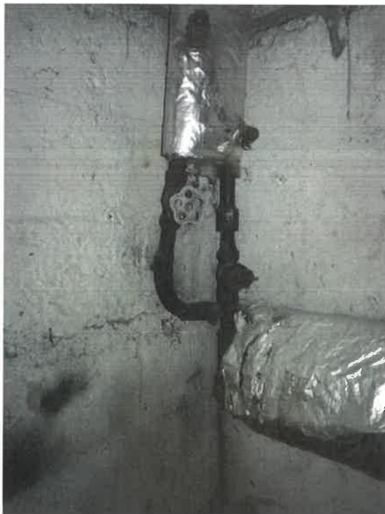
7pav. Drėgmės pažeisti, aprūdiję vamzdžiai rūsyje.
