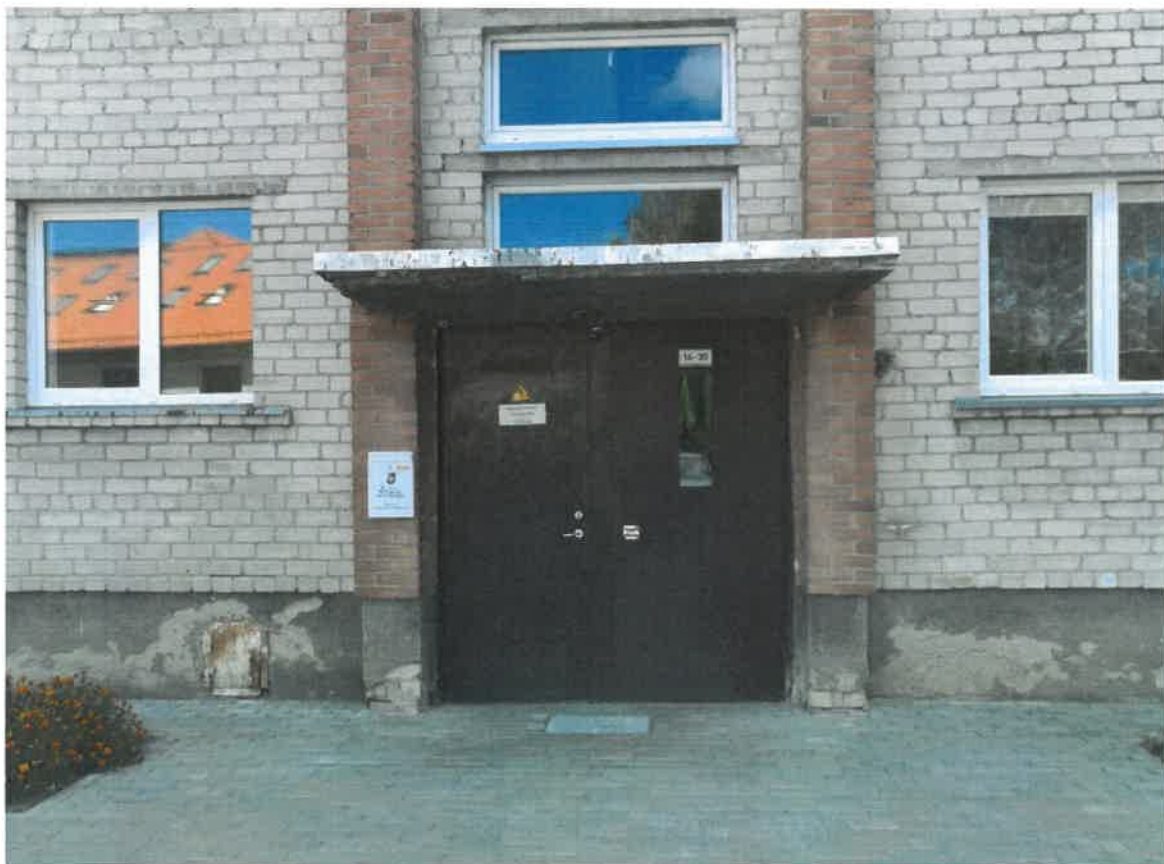
9pav. Pakeistos laiptinės ir rūšio durys, laiptinės langai. Įėjimo stogelių skardinimai paveikti korozijos, prie įėjimų įrengta nuogrinda.
